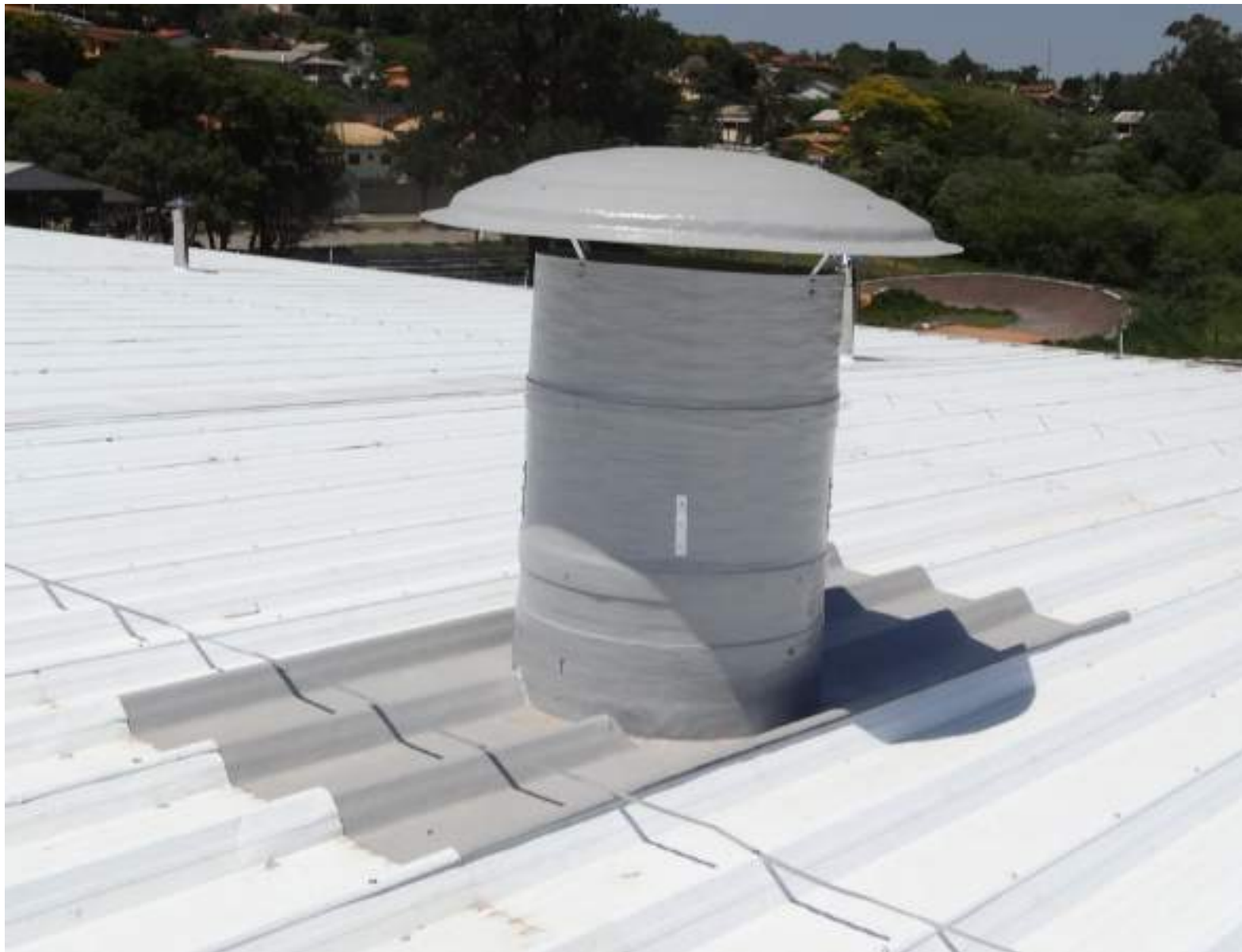
Exaustor de telhado
