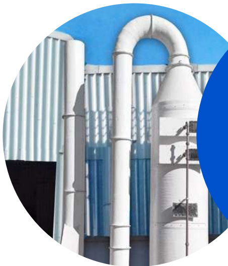
Lavador de Gases
