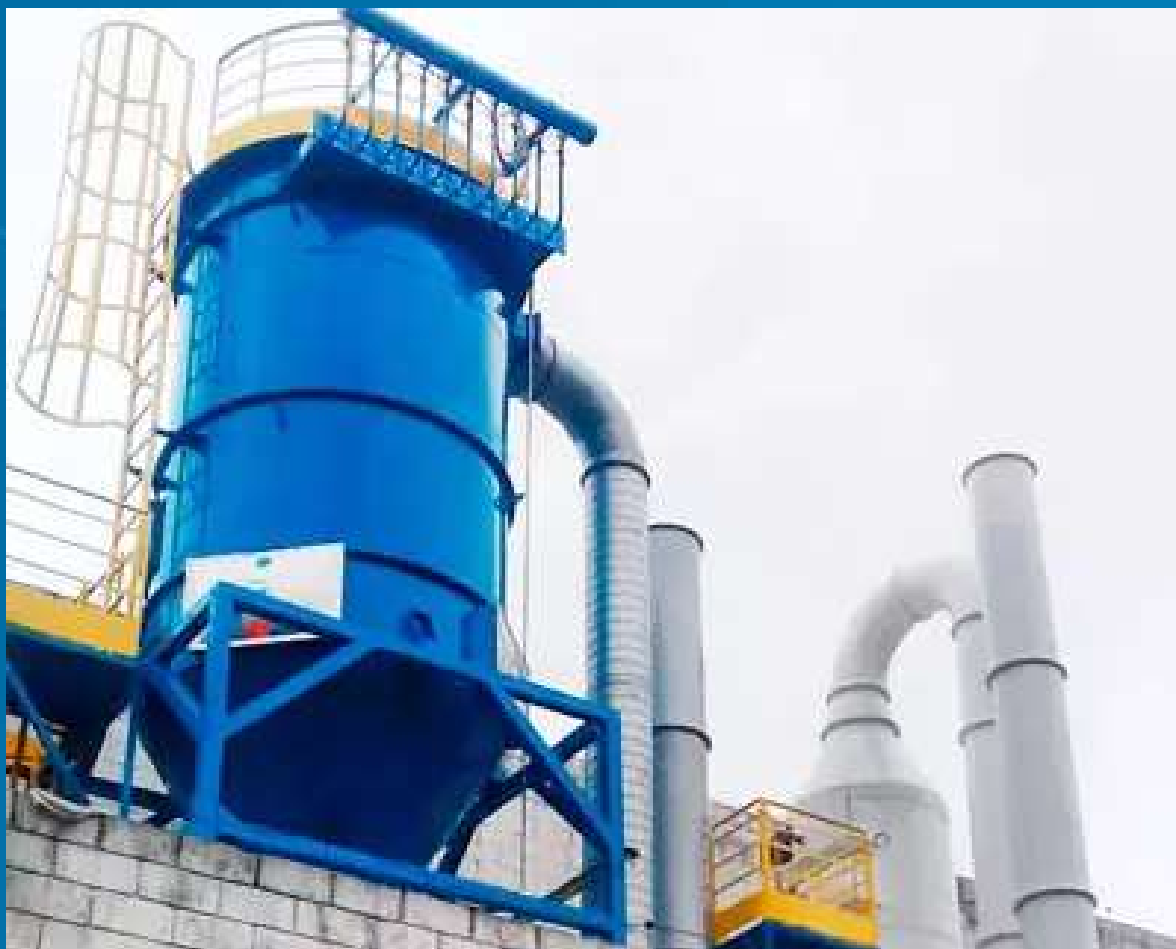
Lavador de Gases (branco) em um sistema com um Filtro de Manga (azul).
